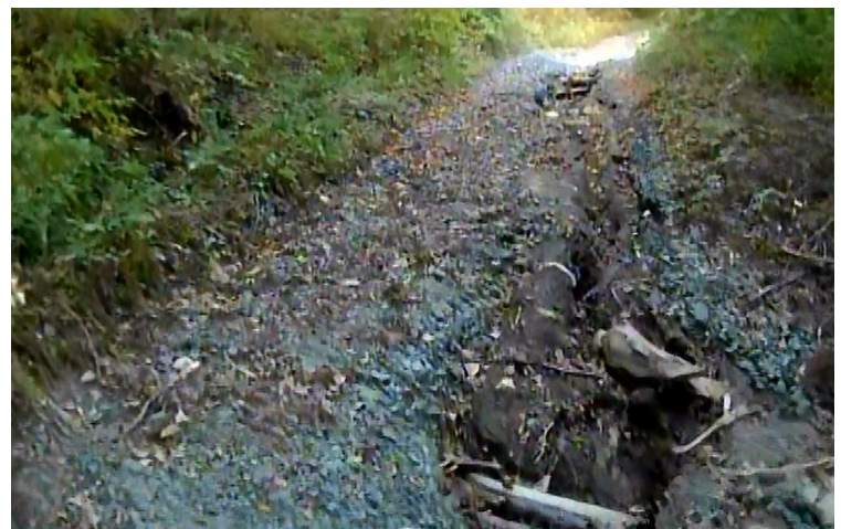
道路被害③ 林道折松一湯ノ岳線
