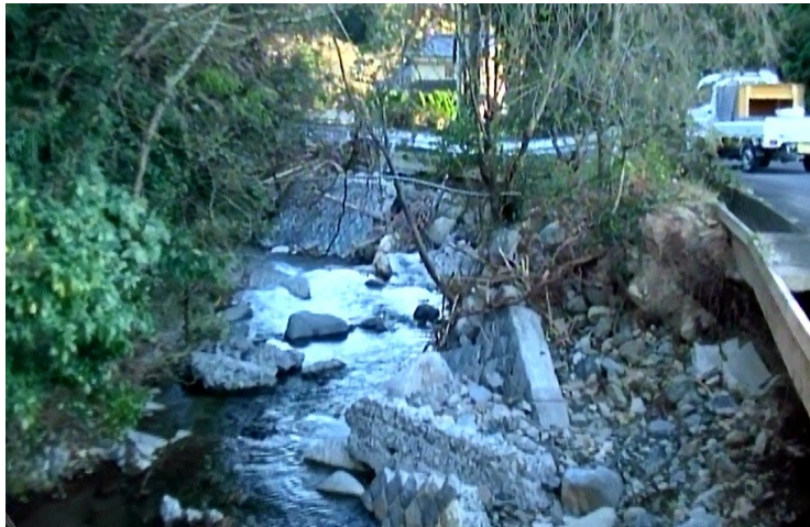
折松川の被害状況③
