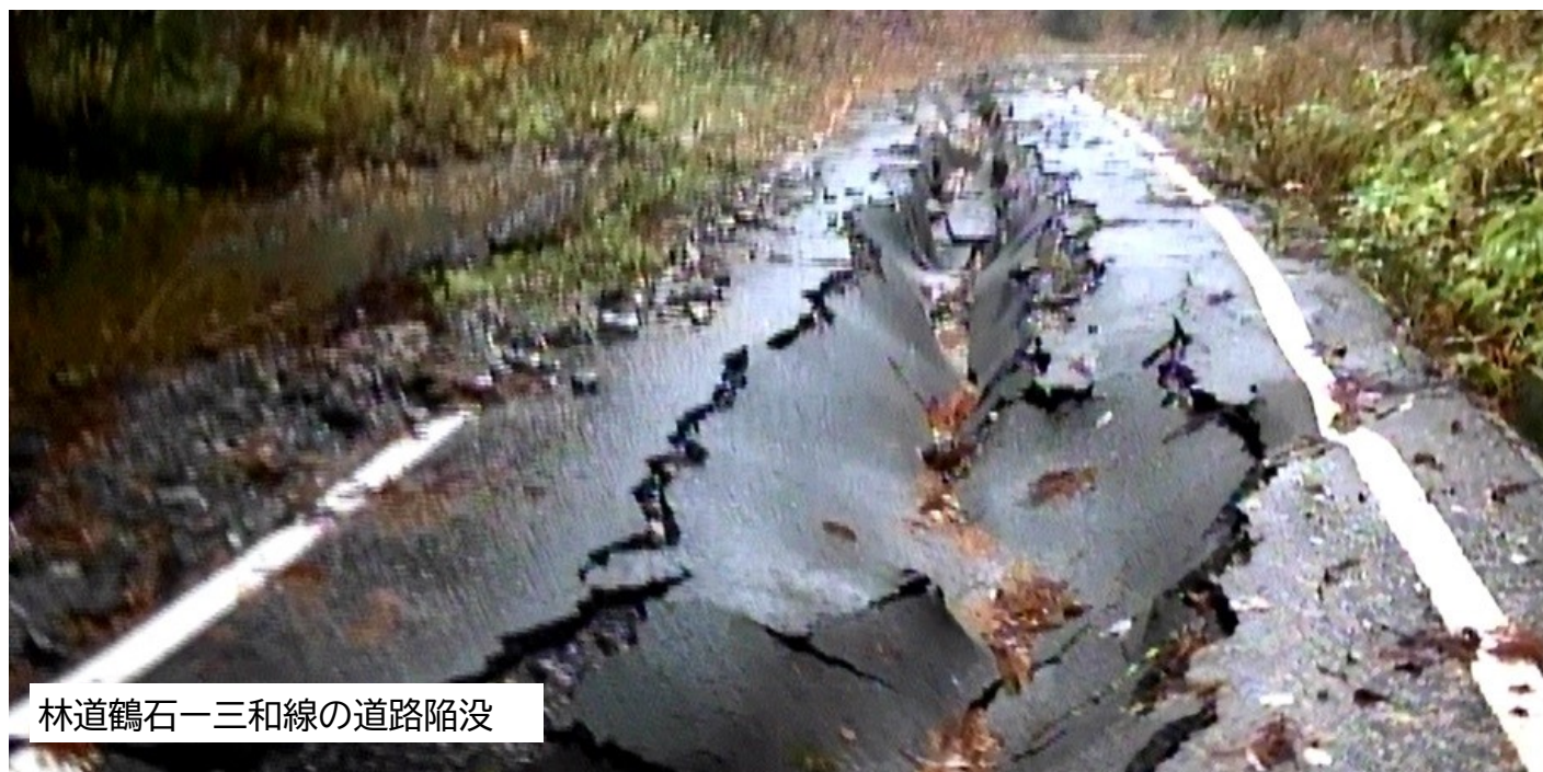
林道鶴石―三和線の土砂崩落
