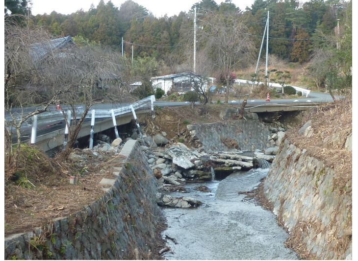
折松川の被害状況②
