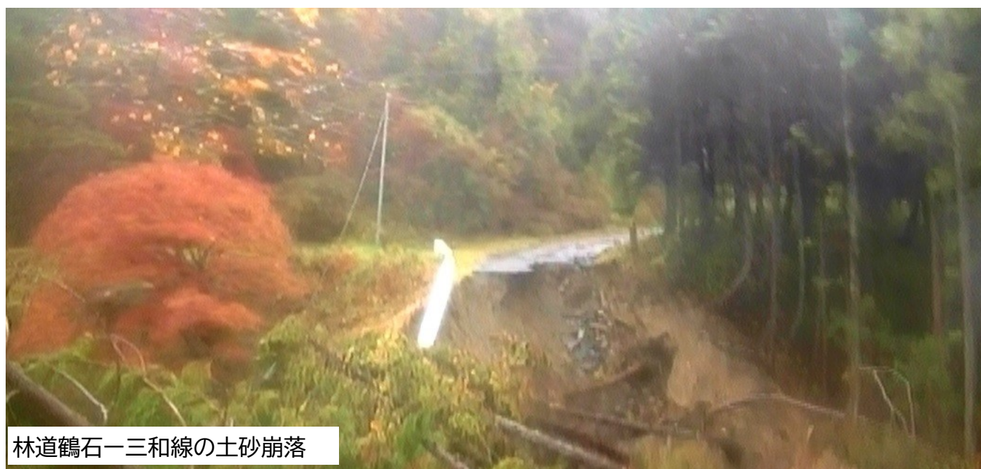
冷水部落北側山系の土砂崩落
