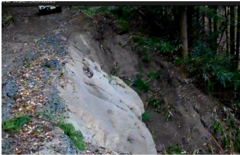
道路被害④ 林道天王一折松線
