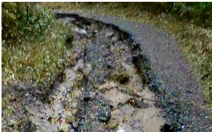
道路被害⑤ 林道天王一鶴石線
